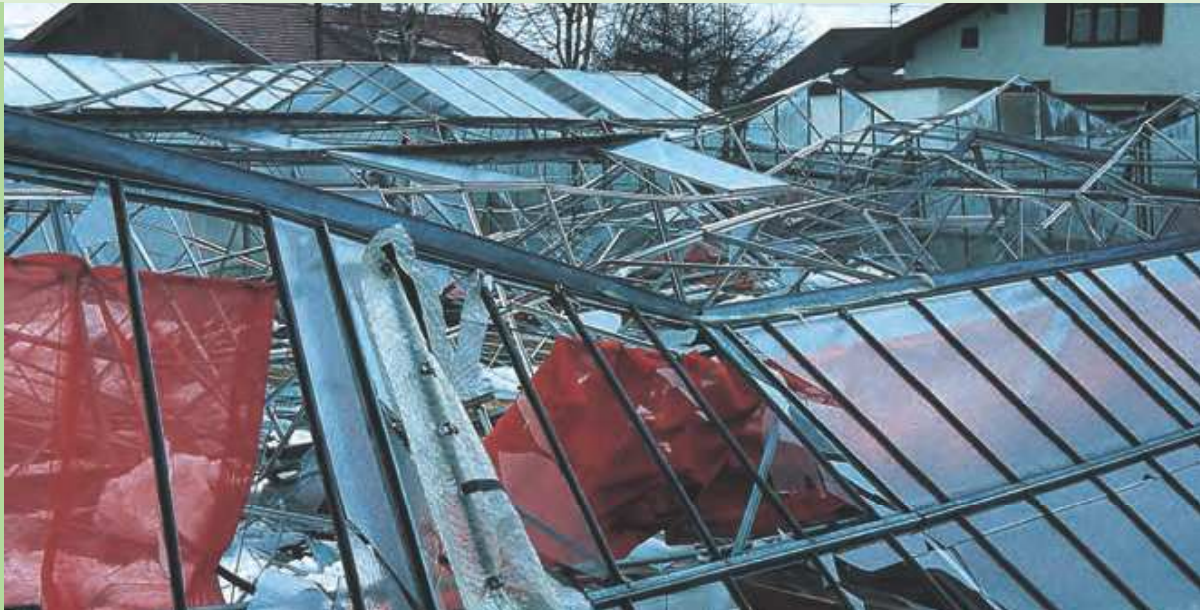
Schaden durch Schneelast in einem ungeheizten Gewächshaus
