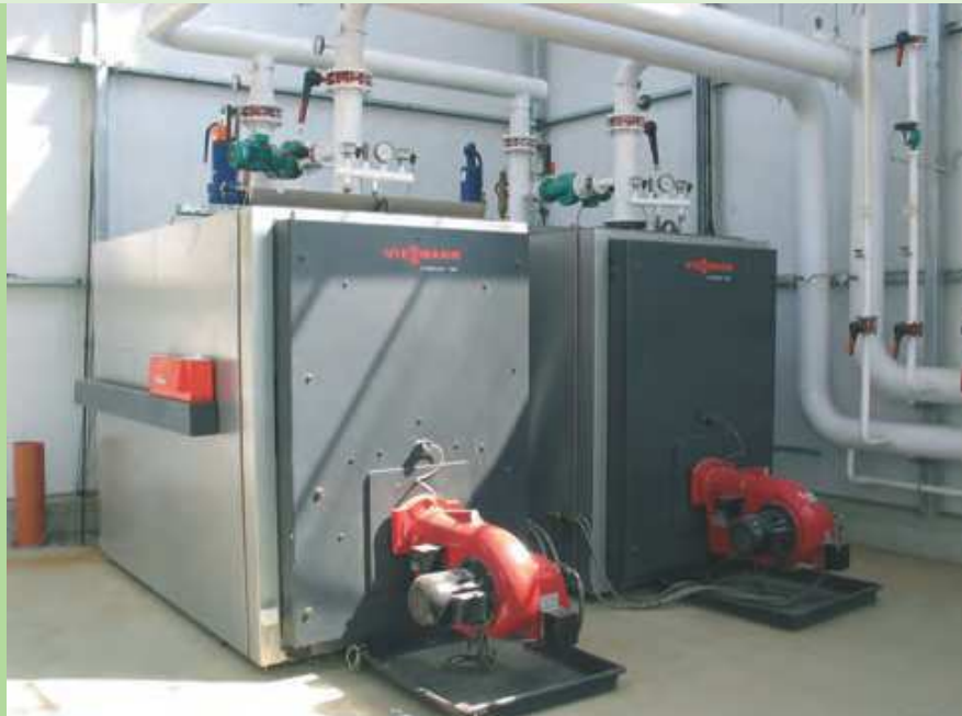
Gesamtansicht einer Heizungsanlage
