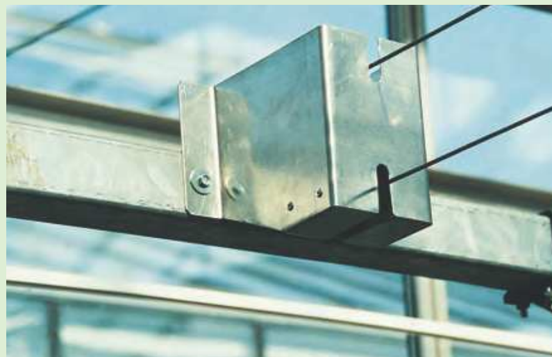
Bild 1 (oben) Ungeschützte Einzugsstelle an einer Umlenkrolle
