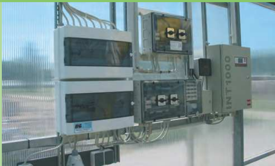
Gesamtansicht einer elektrischen Anlage
