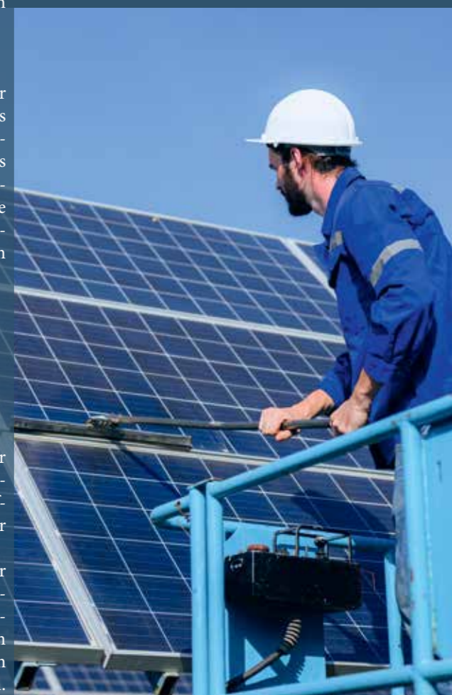
Aus einer Hubarbeitsbühne oder einem Arbeitskorb heraus lassen sich Solarpaneele sicher reinigen.
