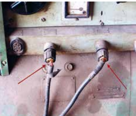
Defekte Anschlüsse stellen eine Gefahr dar, kein Schutz gegen direktes Berühren aktiver Teile
