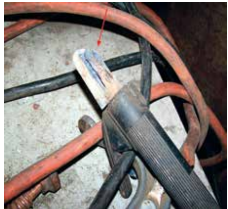
Isolationsschale am Elektrodenhalter defekt
