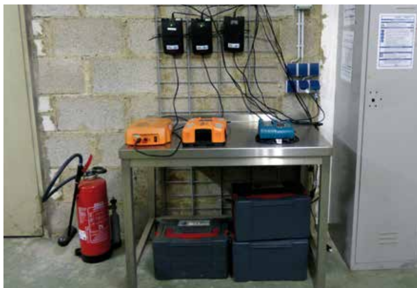
Vorbildliche Ladestation für Lithium-Ionen-Akkus: auf einer feuerfesten Unterlage, mit Abstand zu brennbaren Materialien und einem Feuerlöscher Klasse D
