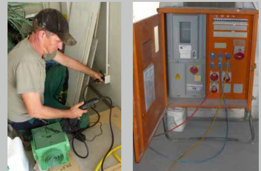
Stromquellen auf Baustellen: Geprüfter PRCD-S Personenschutzschalter oder ein geprüfter Baustromverteiler, der von einer Elektrofachkraft aufgestellt wird.
